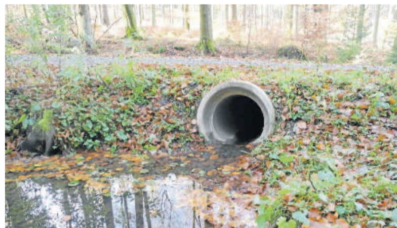
Auch die Durchlassrohre müssen, wie hier, immer mal ausgetauscht werden, damit das Wasser nicht über die Wege fließen kann.
