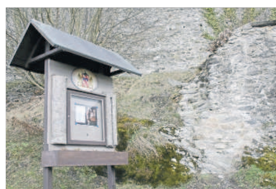
Der Riss an der Südwestecke ist jetzt beseitigt, das Mauerwerk großzügig neu verfügt.
